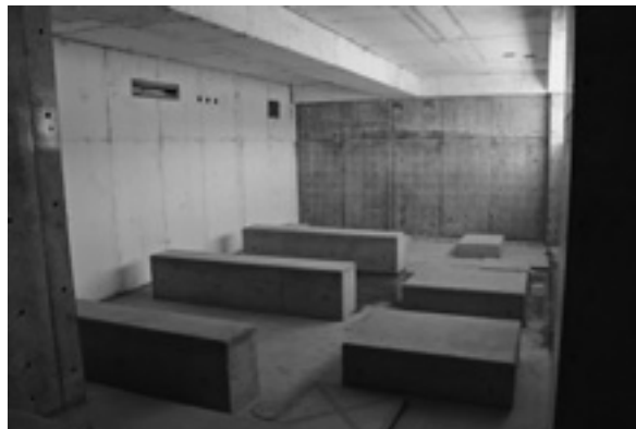
● 受水槽・ポンプ室（機械室）
