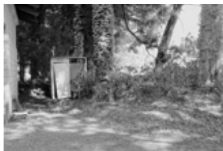
劣化した公衆トイレ
