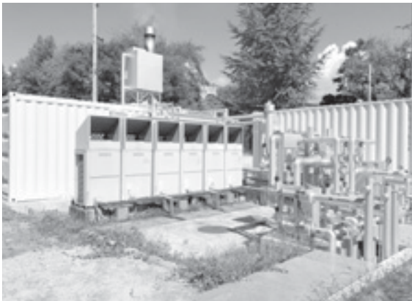
木質バイオマスボイラー
